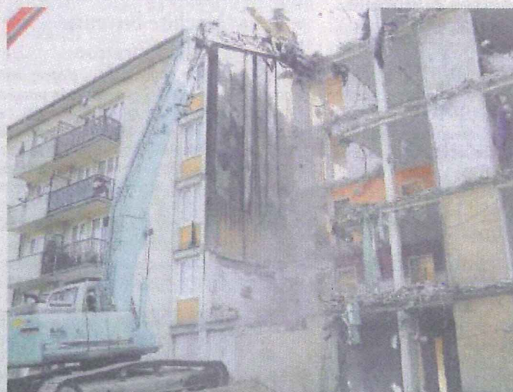
Les 110 logements de cet immeuble vétuste sont démolis depuis le mois d'avril.
